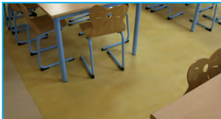
Revêtement de sol en linoléum
