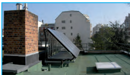
Panneaux solaires thermiques (© Ville d'Issy-les-Moulineaux)
