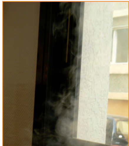
Visualisation des infiltrations d'air sur une fenêtre grâce à une poire à fumée (© ALE Lyon)
