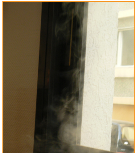
Visualisation des infiltrations d'air sur une fenêtre grâce à une poire à fumée (© ALE Lyon)
