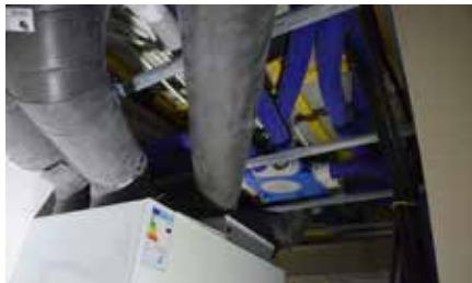
La centrale double-flux concentre de nombreuses entrées et sorties de conduits. Il faut donc anticiper les passages de gaines en faux-plafond.
