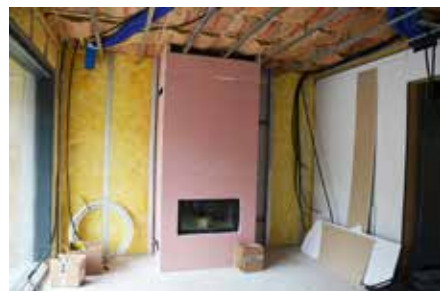
Le poêle prend son air à l'extérieur ce qui permet d'améliorer les gains énergétiques et évite les refoulements de fumées de combustion dans le logement, dus à la mise en dépression créée par la ventilation.
