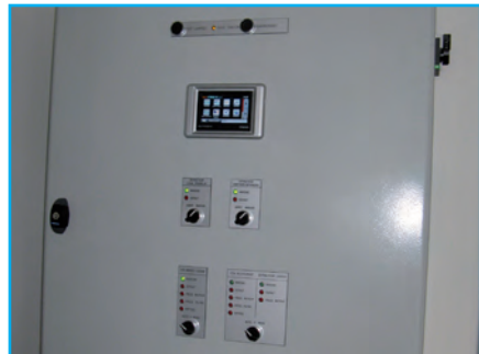
Armoire de Gestion Technique Centralisée pour le chauffage et la ventilation
