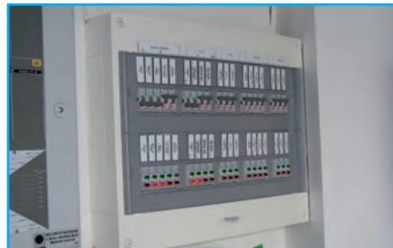
Armoire de Gestion Technique Centralisée pour l'éclairage
