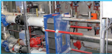
Echangeur avec la sous-station reliée à la chaufferie urbaine
