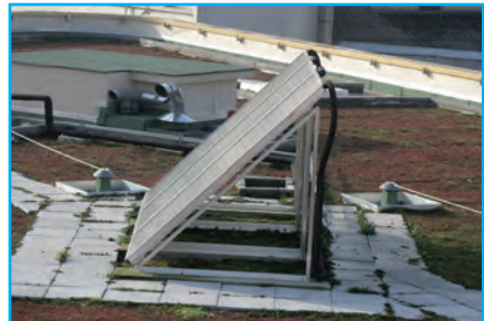
Panneaux solaires thermiques
