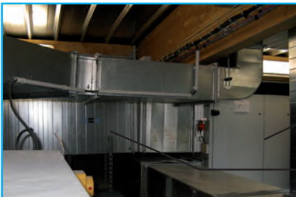
Ventilation Mécanique Contrôlée double flux: avant d'être rejeté à l'extérieur, l'air qui a circulé dans le bâtiment passe dans un échangeur qui en récupère la chaleur pour réchauffer l'air entrant.
