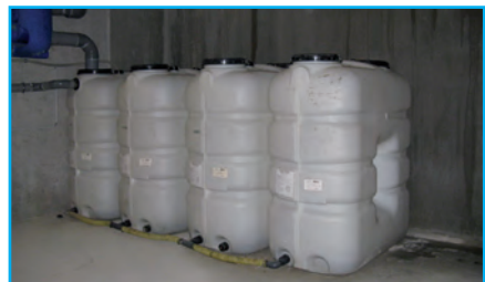
Cuves de récupération d'eau de pluie de 8 m 3 au total situées au sous-sol
