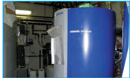
Chaudière gaz à condensation
