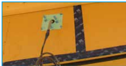
Manchon permettant le passage des câbles électriques tout en limitant les fuites d'air parasites
