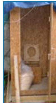
Des toilettes sèches pour limiter l'impact environnemental du chantier Source : Bio Teknik Consulting
