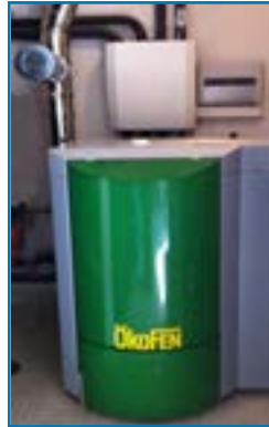
Chaudière bois Source : GPSO Energie
