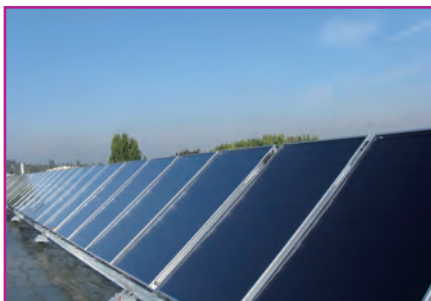
Panneaux solaires thermiques
