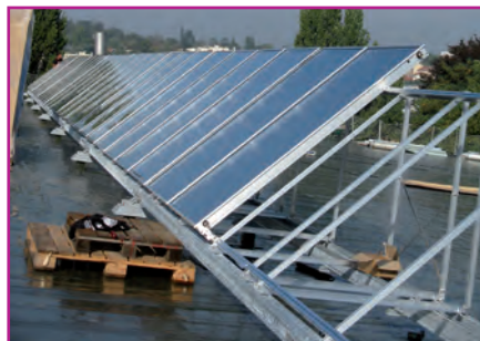
Structure métallique des panneaux
