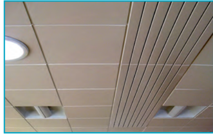
Panneaux radiants au plafond
