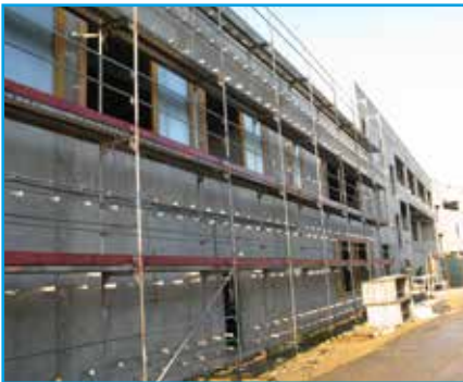
Structure en béton et menuiseries en bois en triple vitrage au Nord
